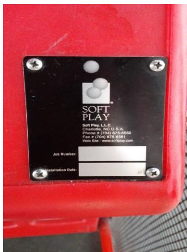
Identificación del equipo con información incompleta
